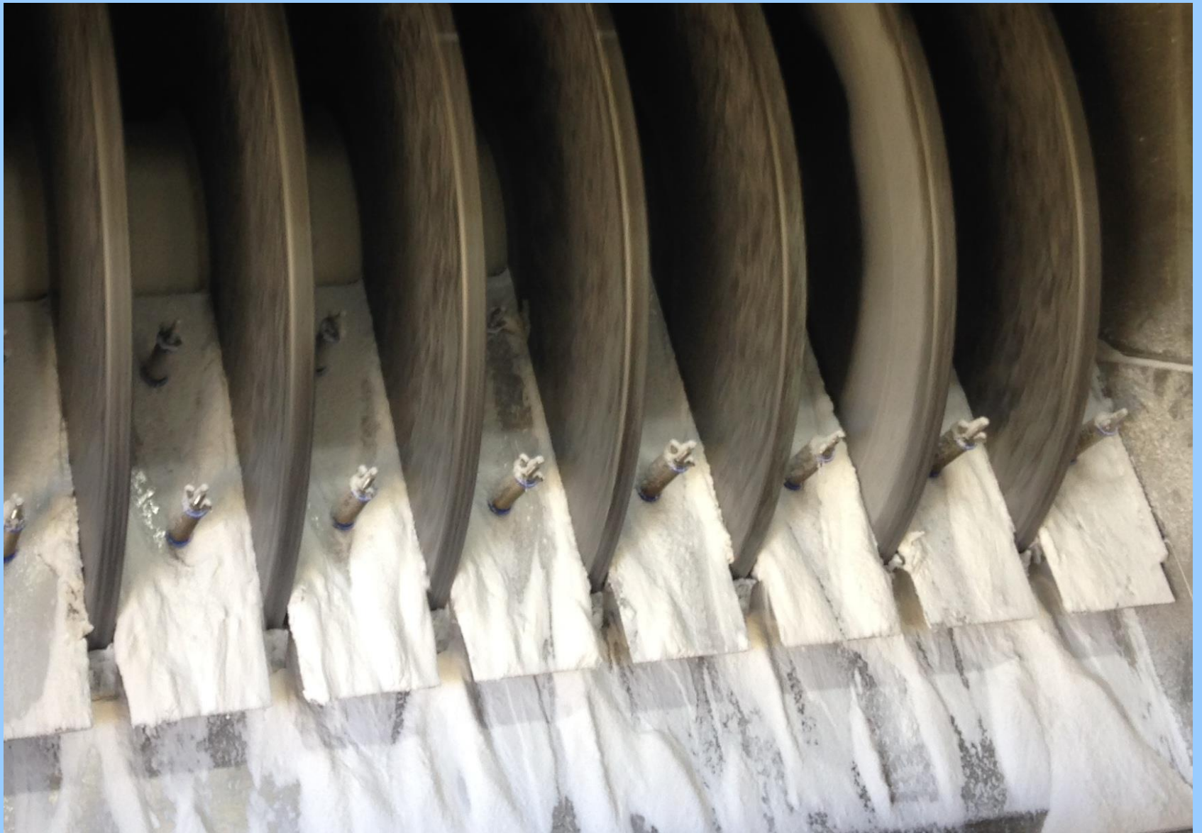
稼働中の様子
