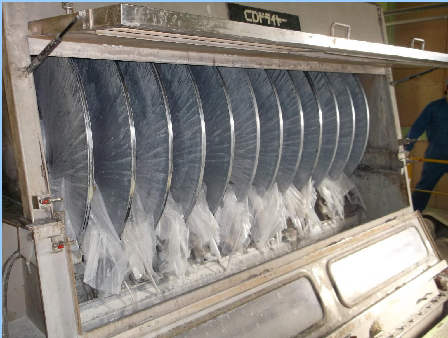
稼働中の様子
